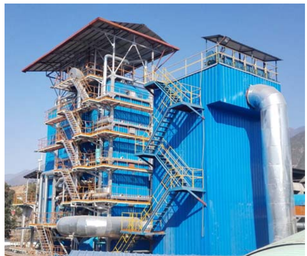
图 3 燃工业固体废弃物多流程循环流化床锅炉
