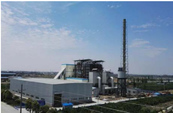
图5 多流程循环流化床锅炉综合能源服务项目
