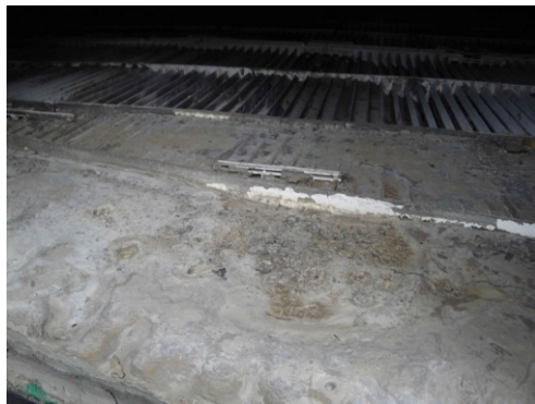
图4 #1吸收塔内除雾器叶片堵塞
